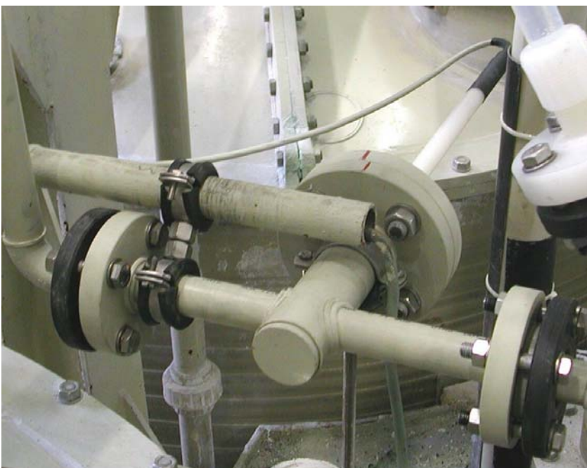
PVDF – Sensor in einer Rohrleitung im Prozess
