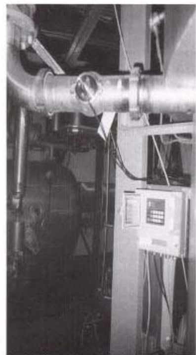
Abb. 2: Messung von Heißwürze mit VARIVENT-Armatur.
